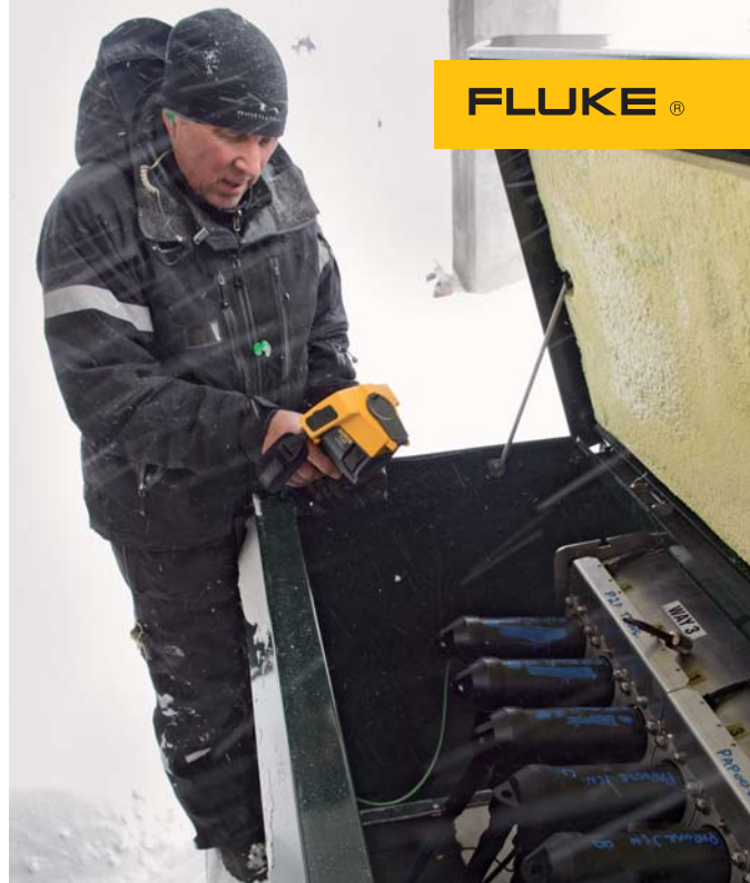
Le condizioni estreme che si trovano presso la stazione sciistica di Whistler nel Canada occidentale non sono un problema per le termocamere Fluke.
